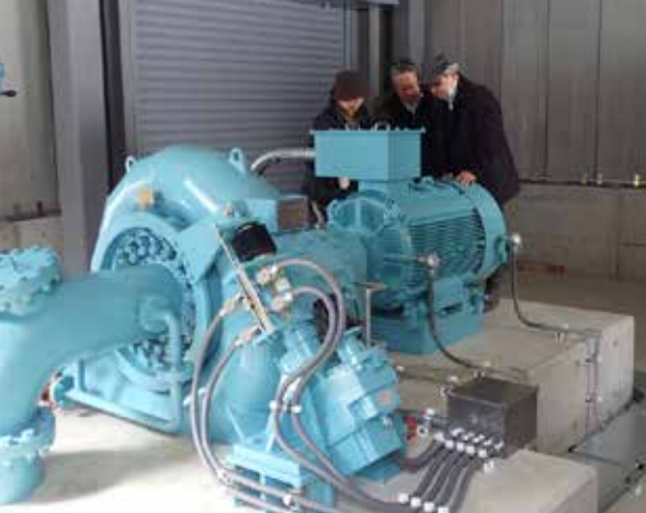
発電所建屋内のフランス水車。 出力160kWで、200軒以上の電力 需要を賄える
